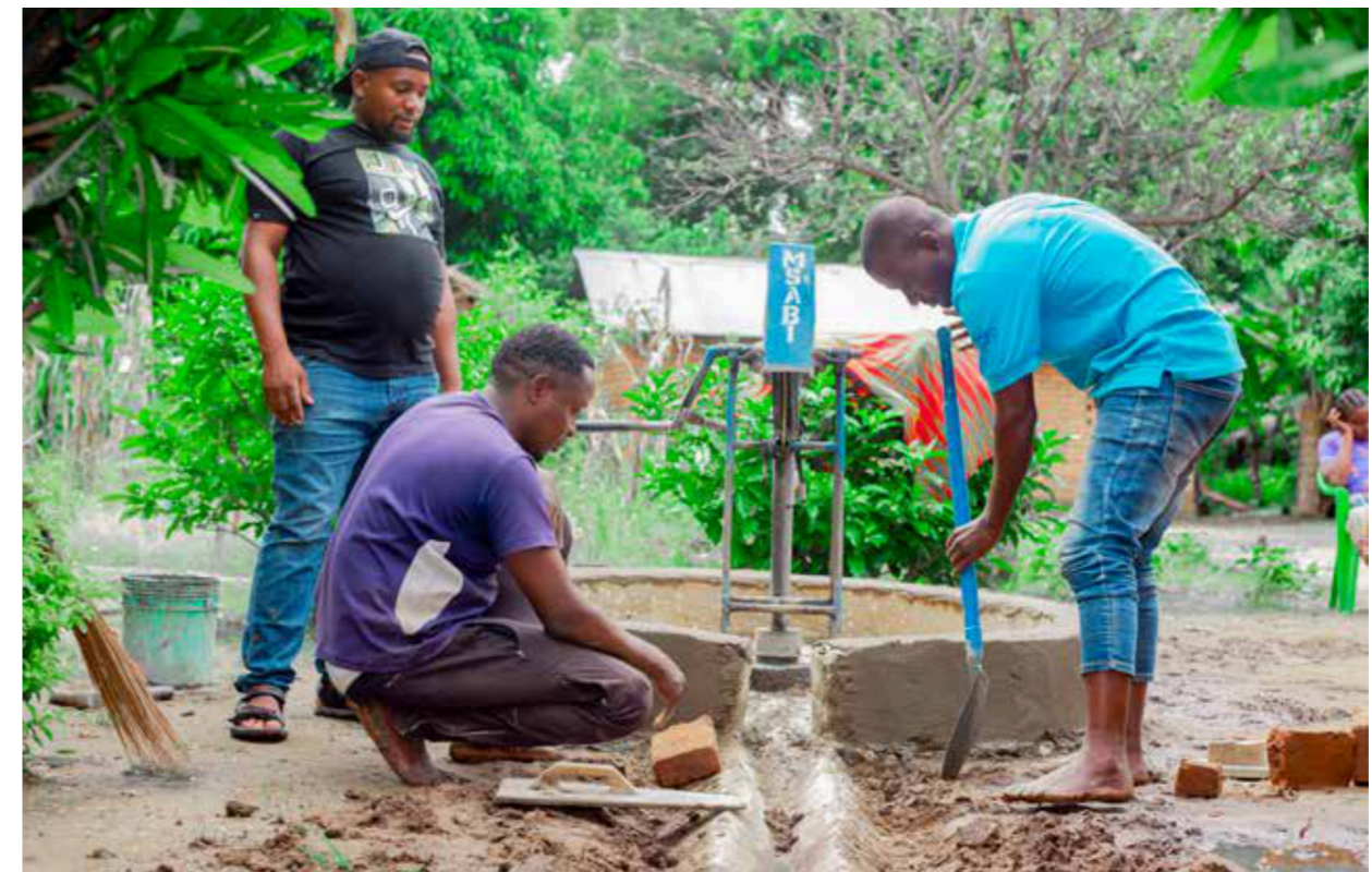
Die Wasserpumpen für 10000 Menschen funktionieren wieder – Schulungen und nachhaltige Wartungsmodelle sorgen dafür, dass es auch so bleibt.
